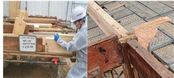
그림 7. 한국 운현궁 아재당 결구부 창방 훼손부 금속봉 삽입 (출처 : 전통건축수리기술진흥재단, 『목부재 재사용을 위한 보수·보강 안내서』, 2024, p.172)
